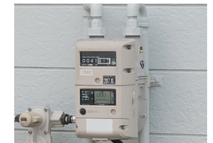
スマートメーター
