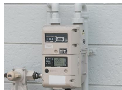
スマートメーター
